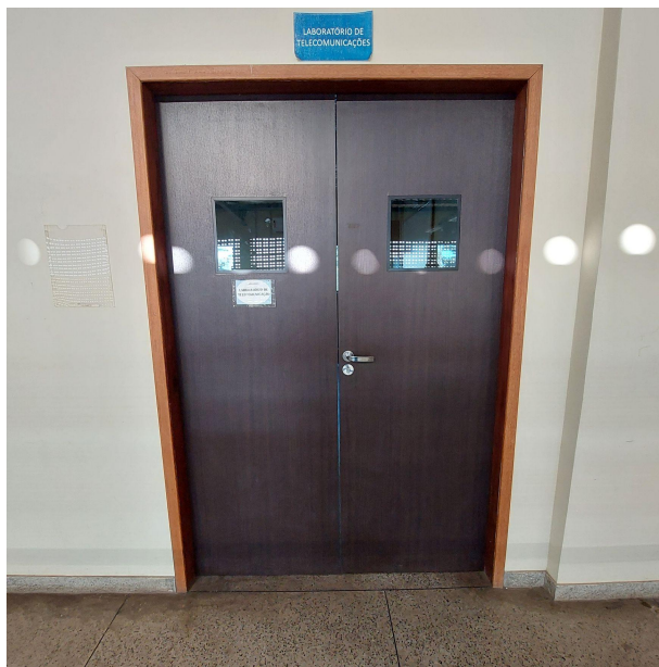
Figura 01 - Fechadura Mecânica dos Laboratórios do Galpão.
